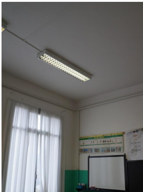
Figura 4.15 - Particolare dei corpi illuminanti ubicati nelle aule
