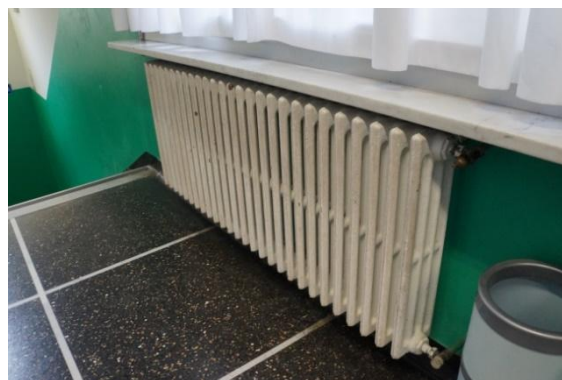
Figura 4.6 - Particolare del radiatore installato in prossimità del corpo scala
