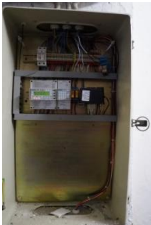
Figura 4.7 – Centralina di controllo in CT
