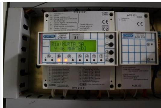
Figura 4.8 – Particolare della Centralina di controllo in CT
