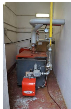
Figura 8.5 – Particolare della centrale termica
