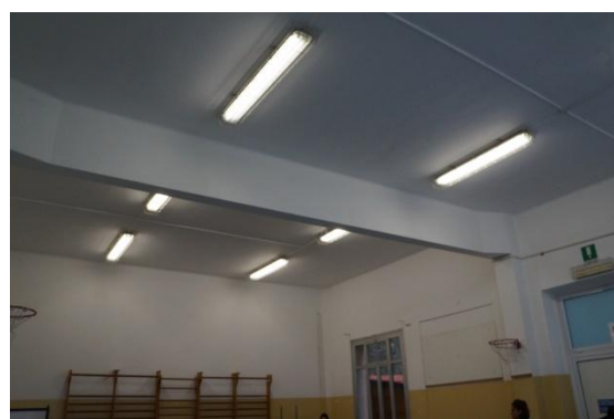
Figura 4.14 - Particolare dei corpi illuminanti ubicati in palestra.
