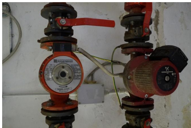
Figura 8.7 – Particolare pompe di circolazione
